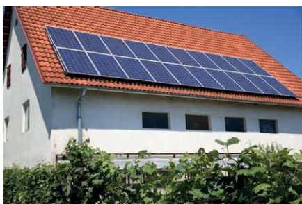
PV-Anlagen auf Dachflächen
